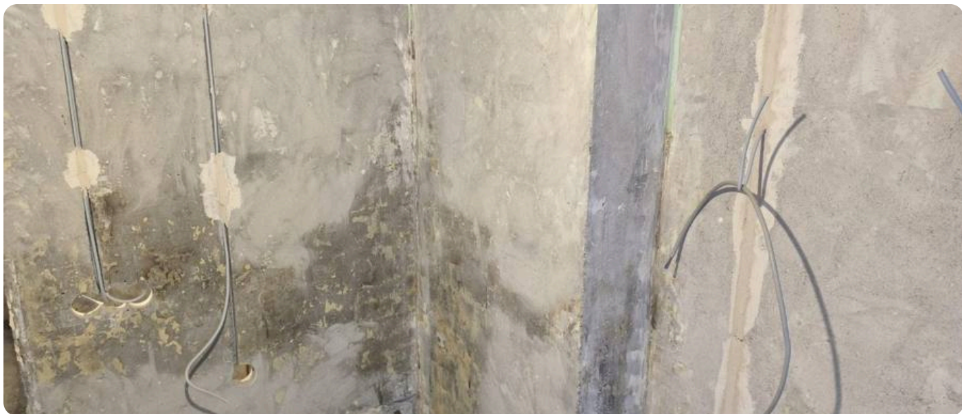
Что вскрывается при демонтаже: старая проводка и штробы в бетоне
